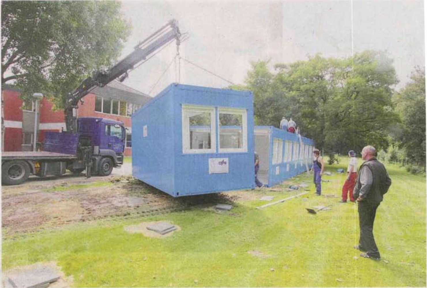
Am Schulzentrum in Buschhausen werden derzeit mobile Räumlichkeiten in Form von Containern aufgebaut, um alle Schüler unterbringen zu können, die zum neuen Schuljahr aus dem alten Realschulgebäude an der Lange Straße an die Mensingstraße umziehen. FOTO: MICHAEL RABBA
