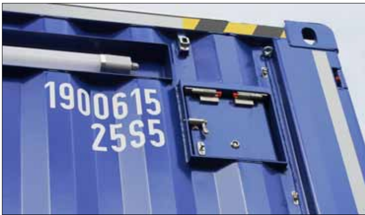
Vor Inbetriebnahme der Lüftungsanlage müssen außen zwei Klappen für Zu- und Abluft geöffnet werden.
