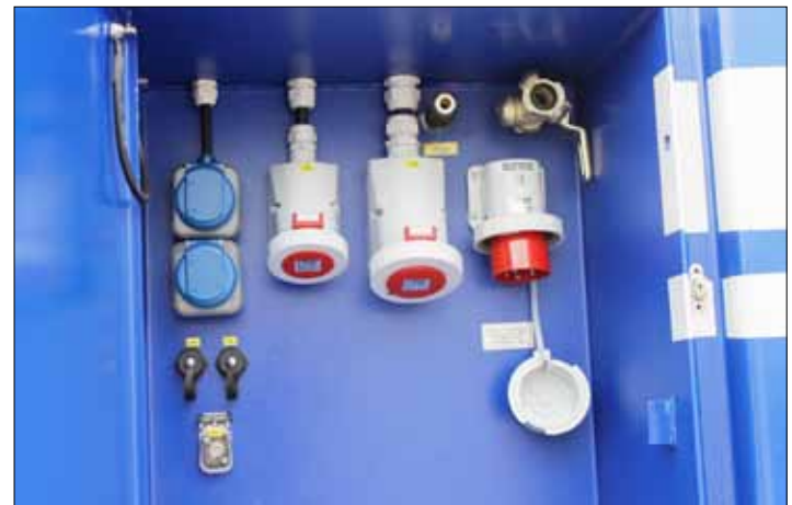
Hinter einer Klappe rechts der Seitentür: Energieeinspeisung mit Abnahme Drehstrom 32A und 16A, 220V Wechselstrom, Anschlüsse Netzwerk und Funk sowie Druckluft.
